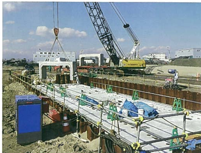
国土交通省東北地方整備局仙台河川国道事務所 仙台湾南部海岸 深沼北工区北部第3復旧工事
