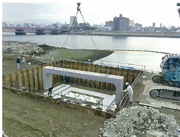
写真-8 設置状況
